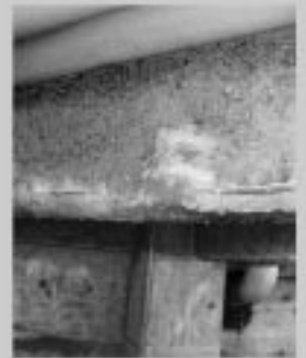
傷ついた吹き付けアスベスト
