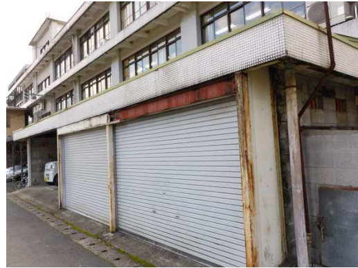
老朽化の状況
