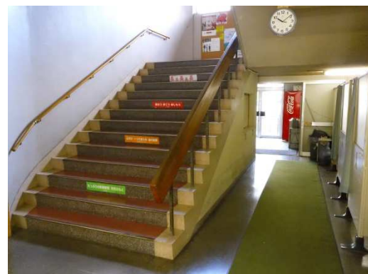
エレベーター未設置
