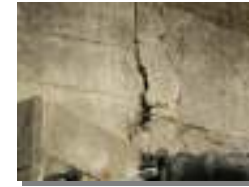
コンクリートのひび割れ
