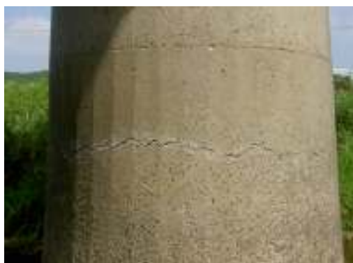
(橋脚のひびわれ)
